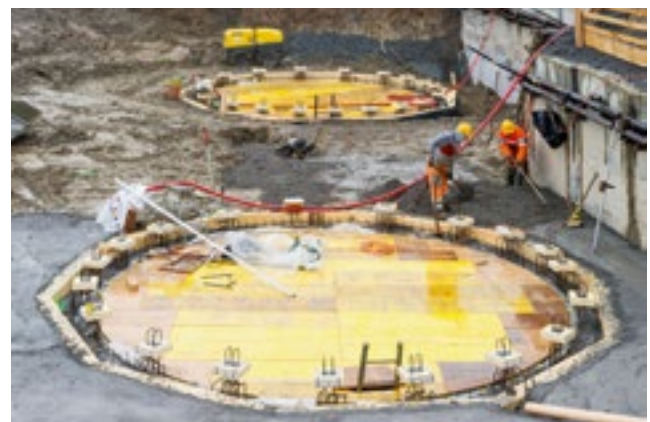
Zur Speicherung von thermischer Energie dienen zwei unterirdische Wassertanks mit einem Durchmesser von je 6 m.
